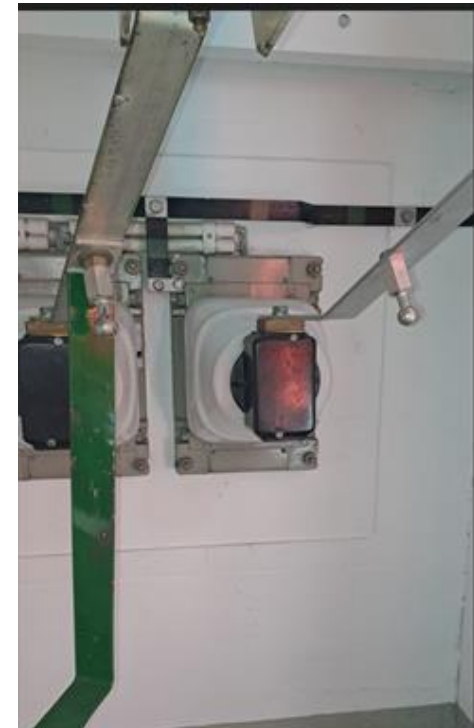
Umbau von Durchführungsstromwandler
